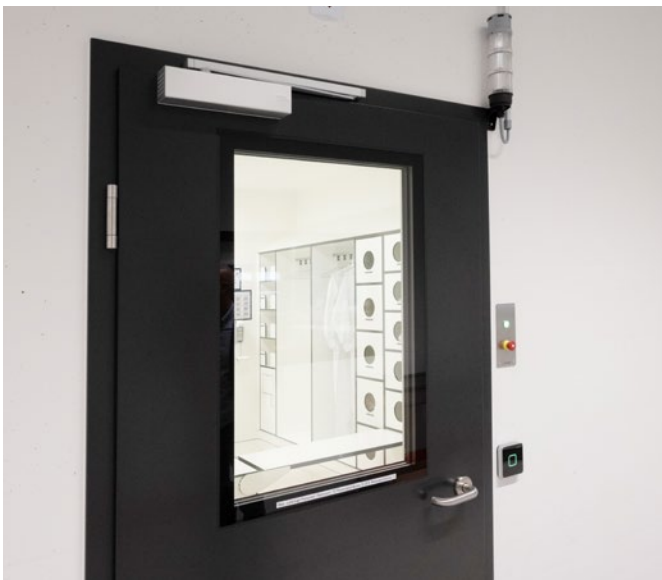
Vista della camera di compensazione per il personale nella nuova camera bianca. Sopra la porta è stata installata una spia RMS che attiva un allarme acustico e visivo in caso di emergenza.
