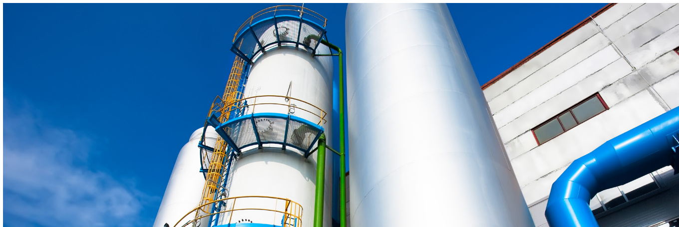
Impianto di frazionamento dell'aria
